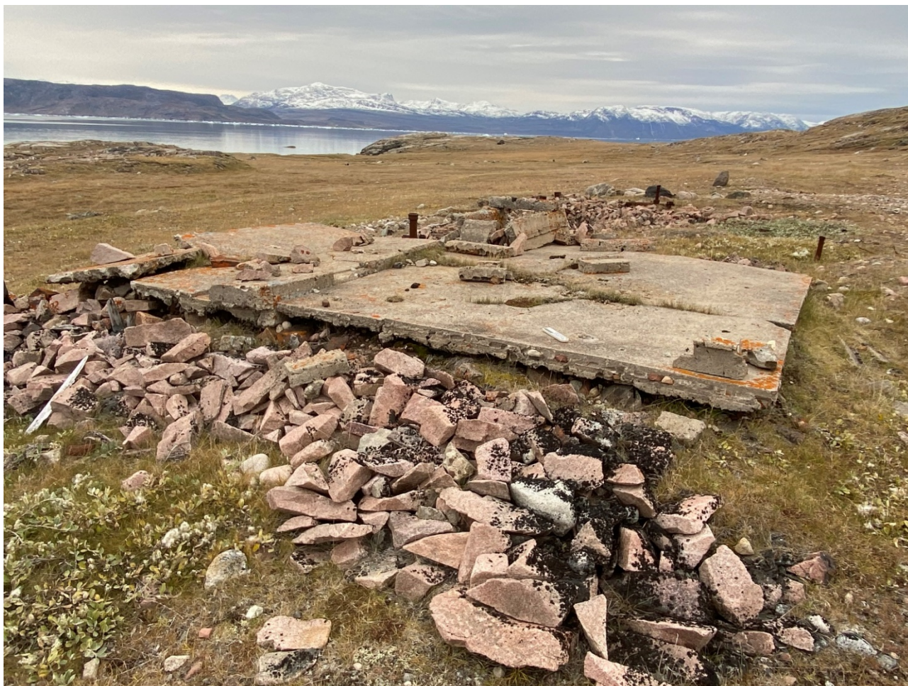
Fig. 85. F002 på Artillery Point. Betonplatformen er i ekstremt dårlig stand med synlige brud og revner på grund af udsættelse for vind, regn og is i løbet af de seneste mere end 70 år. Foto: Harmsen, 2020, sydlig retning.
