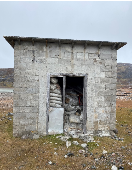
Fig. 101. Bygning B004 viser cementblandingsækkene der er størknet og nu forbliver en permanent del af konstruktionen. Foto: Harmsen, 2020.
