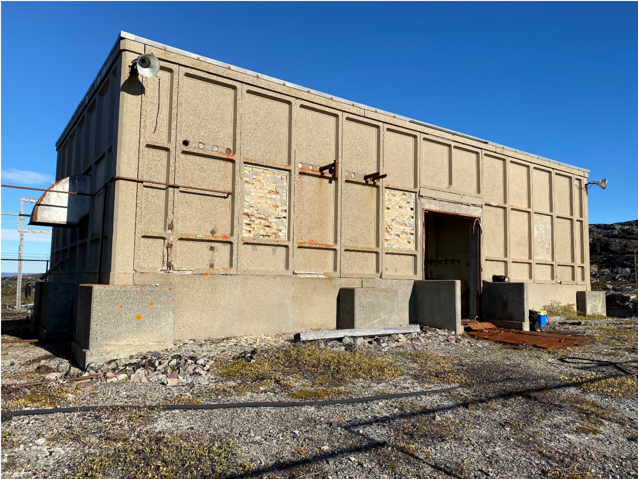
Fig. 16. Forsiden af B452, nordvestlig retning. Den store ståldør er faldet ud og gør det indre af bygningen udsat for vind og vejr. Foto: Harmsen 2020.
