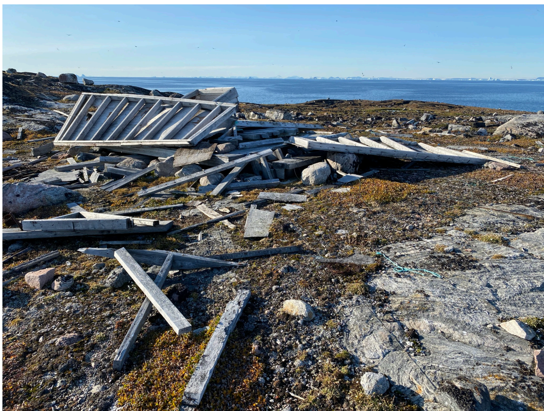
Figur 9. Den sammenfaldne NDB-bygning set fra syd. I forgrunden til højre anes de kobberwires der i stråleform udgår fra bygningen. (Foto: M. Myrup)
