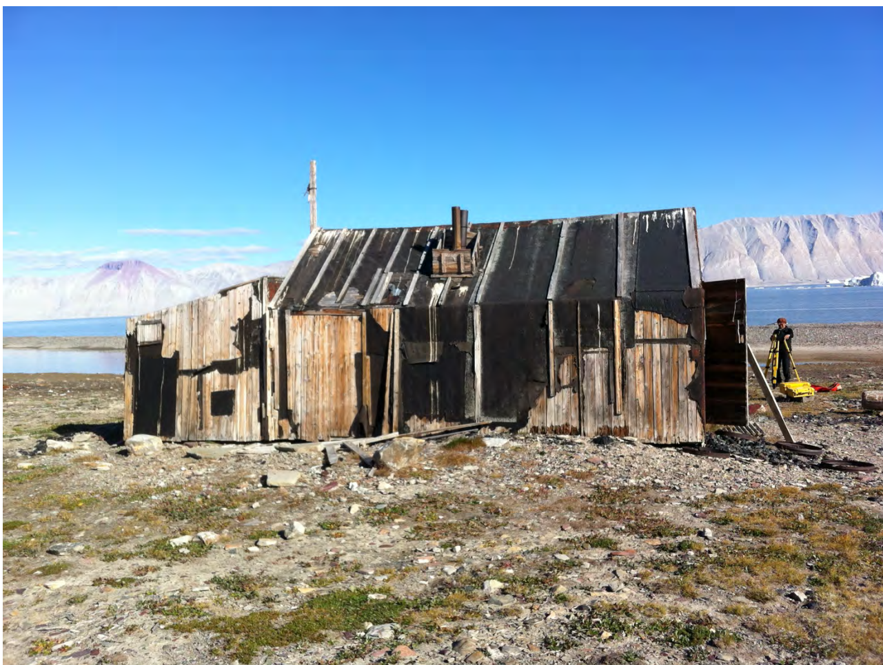
Strindberg, bygningstilstand 2012 – Foto: Peter Schmidt Mikkelsen
