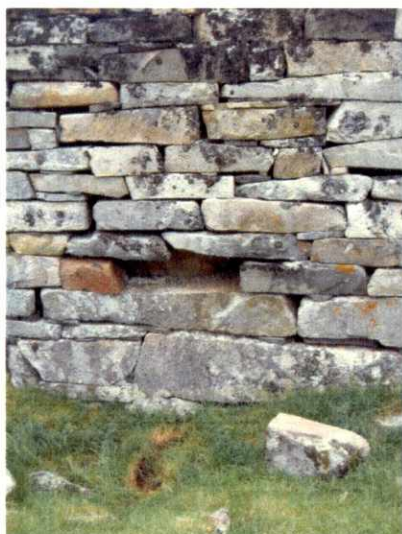
Fig. 47. Nedfalden sten i kirkens nordmur
