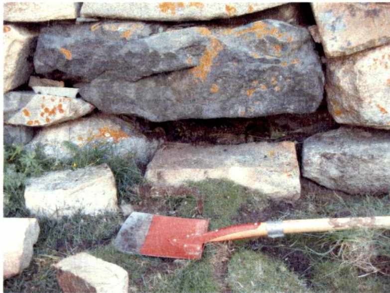
Fig. 51. Manglende sten i nederst murværket under korvinduet.
