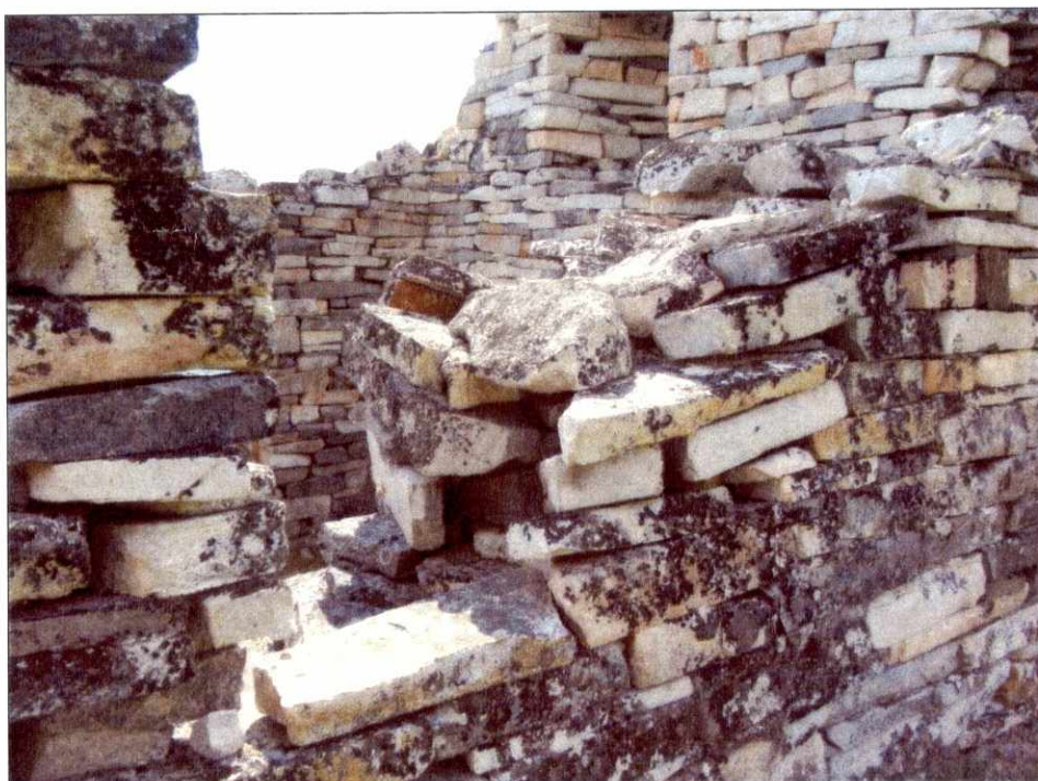
Vinduesnichen i nordvæggen – kan endnu nå at blive stabiliseret!
