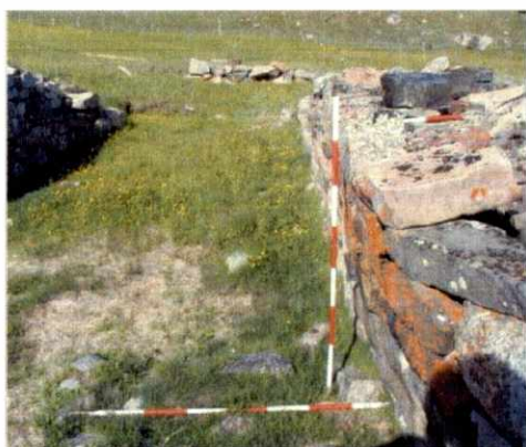
Figur 10. Kirkens nordvæg skræner indad som følge af sætning i fundamentet. Situationen synes dog stabil.
